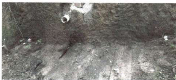
Foto 3: La calda de aguas de sanitarios solo es de tabla, se va a construir de concreto (tapadera y su base de concreto)
